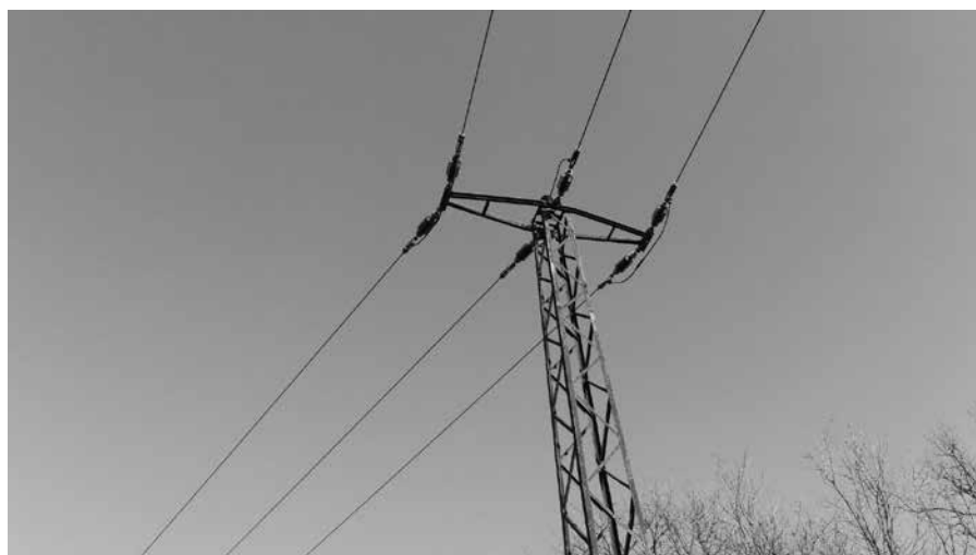
Smrtečně nebezpečný rohový sloup vysokého napětí s izolátorem nad středem konzole (foto V. Beran)
